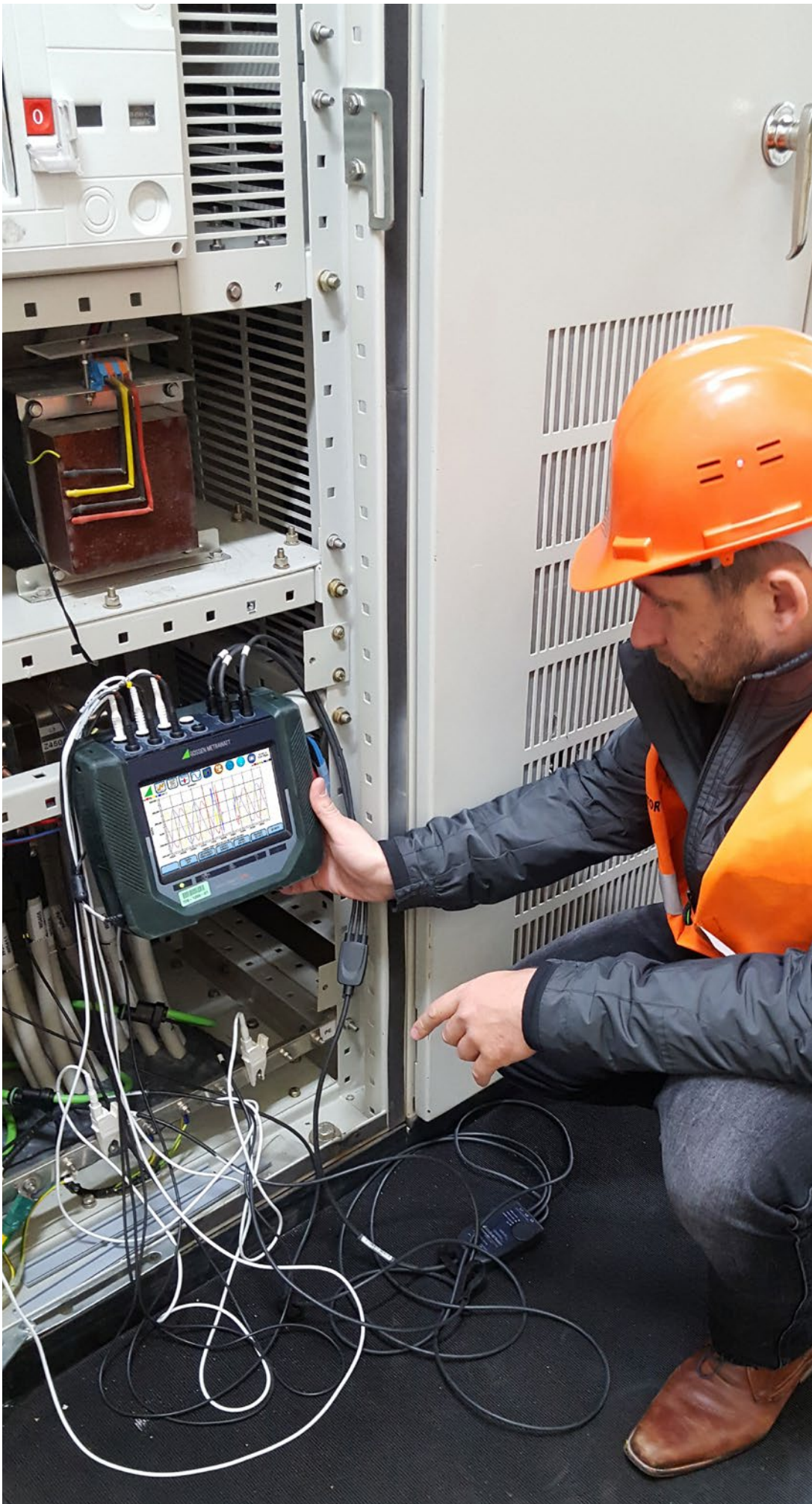
Mit dem MAVOWATT-Geräten kann der Techniker auf einen Blick Probleme erkennen und lokalisieren.
