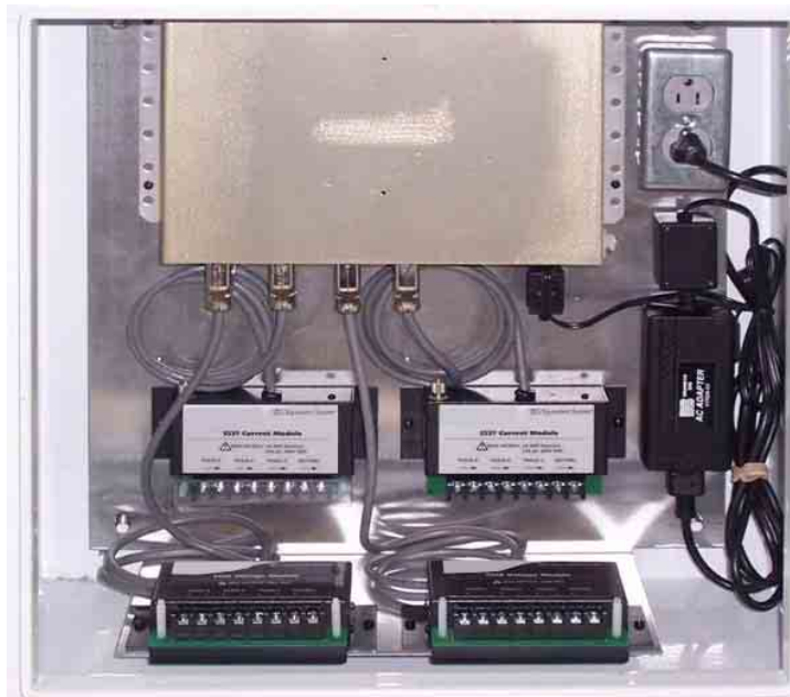
Abbildung 34 Im NEMA 4 Modul-Gehäuse befinden sich das Standardgerät 61STD, das an jeweils zwei Spannungs- und Strom-Eingangsmodule angeschlossen ist. Rechts im NEMA 4-Gehäuse ist die Stromanschlussleiste.
