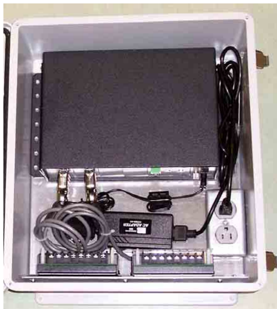
Abbildung 37 Im NEMA Gehäuse befinden sich das Standardgerät 61STD, angeschlossen an Spannungs- und Strom-Eingangsmodule. Rechts sieht man die Stromanschlussleiste.
