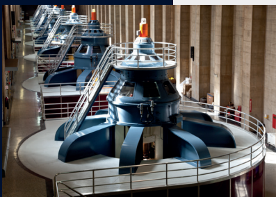
ENERGIEERZEUGUNG UND -VERTEILUNG
